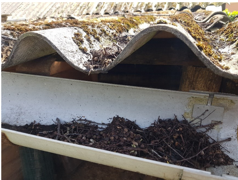
Figuur 5. Onder de dakbedekking is geen beschot aanwezig waardoor er geen geschikte tussenruimtes aanwezig zijn.
