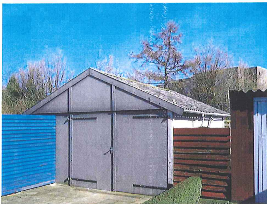
Foto 5 St. Willibrordusstraat 20 – Schuur met asbest golfplaten
