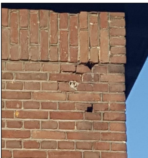
Figuur 3.5 kapotte baksteen Complex 2-0118
