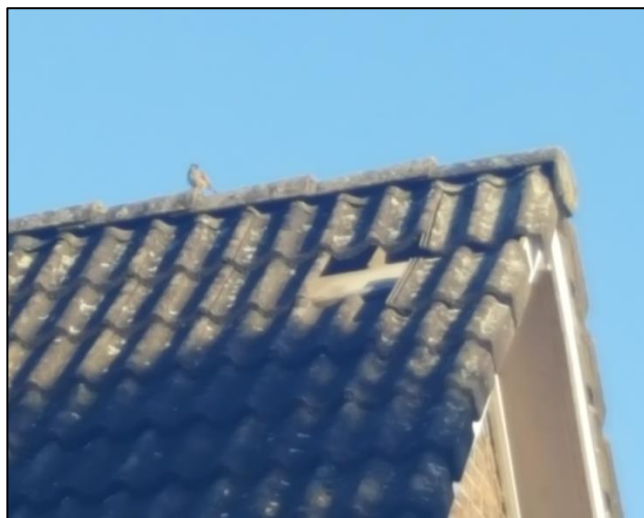
Figuur 3.4 missende dakpan met huismus Complex 2-0118
