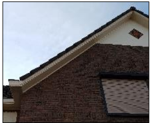
Figuur 3.2 Complex 2-0381 spleten onder dakpannen
