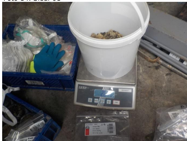
Foto 16. Aangetroffen asbest AV05 (2706g)
