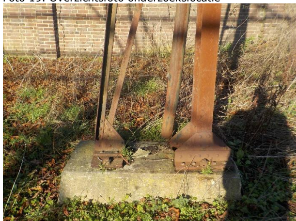
Foto 21. Asbestverdacht materiaal maaiveldinspectie
