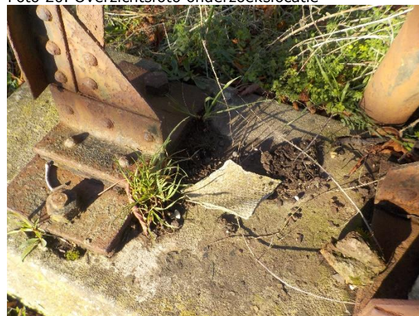
Foto 22. Asbestverdacht materiaal maaiveldinspectie
