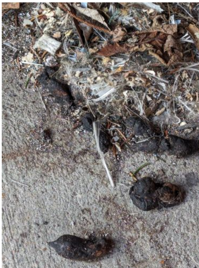
Vossen uitwerpselen op de betonnen ondergrond, links van de poort van schuur 2.
