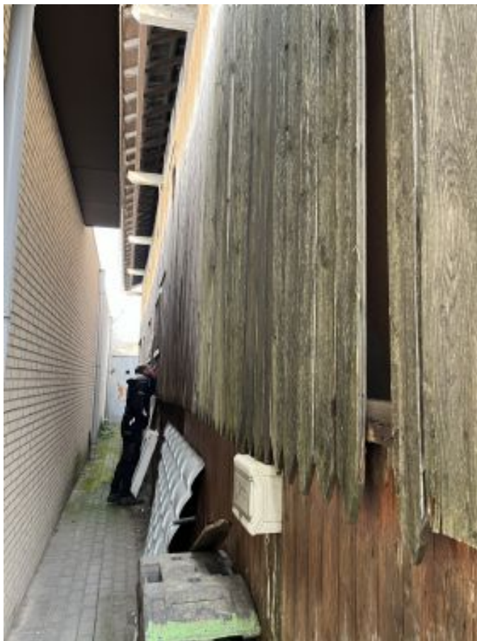
De westkant van gebouw nummer (2) wordt geïnspecteerd. Achter de loshangende planken bevonden zich hier houten platen.
