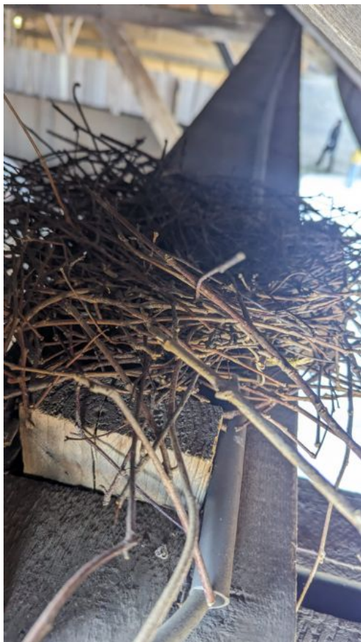
Duivennest op een draagbalk, aangetroffen op de hoek van gebouw 6.
