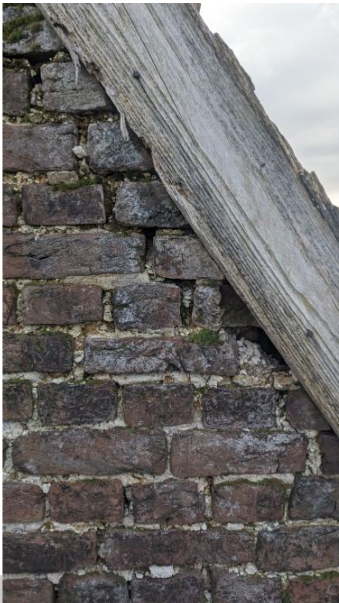
Voorgevel gebouw 8, met kieren die naar de zolderruimte onder de dakpannen leiden.
