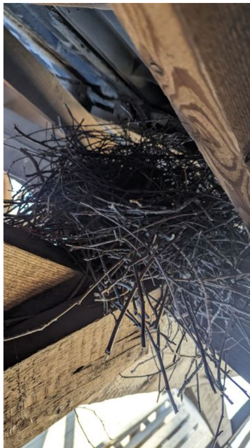
Duivennest onder het dak van gebouw 7.
