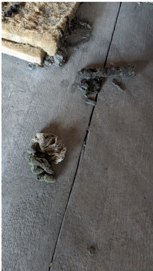
Op de verdiepingsvloeren van de opslagruimtes werden steenmarter uitwerpselen gevonden (gebouw 5).
