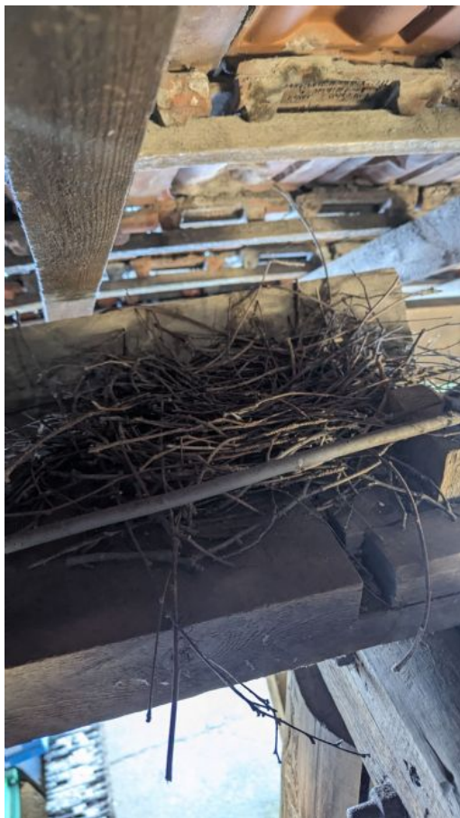
Onder het dak van gebouw 5 bevindt zich een duiven nest.
