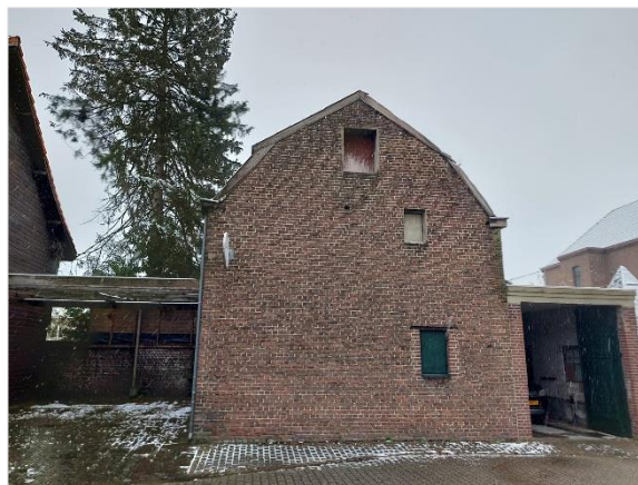
Figuur 5-2. Bebouwing op de onderzoekslocatie bevat verschillende spleten bij zowel de dakranden als aan de gevel.
