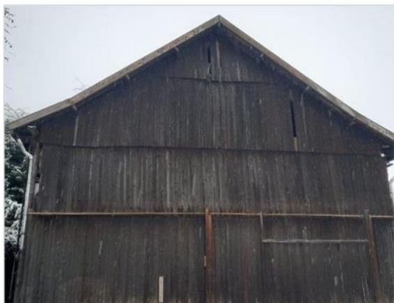
Figuur 5-1. Bebouwing op de onderzoekslocatie is sterk verouderd en heeft verschillende openingen en kieren.
