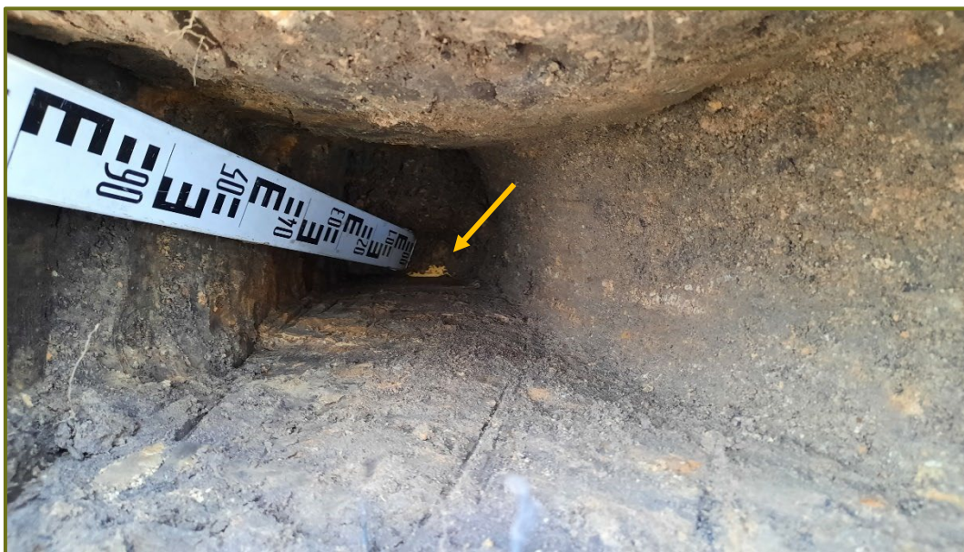
Afbeelding 34. In de grasberm tussen het huidige fiets en voetpad ligt een gasleiding op 100 cm beneden maaiveld zie pijl. Geen boomwortels.
