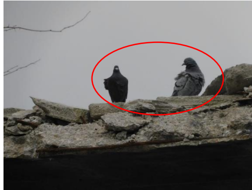
Duiven op het betonnen geraamte Wal 15
