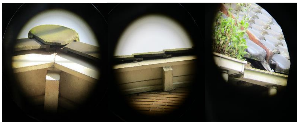
Figuur 4 Kierende pannen op het dak van het voormalige basisschoolgebouw aan de Molendijk 2A te Rhoon.
