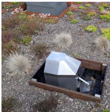
'Slim' waterbergend dak, Zuidas, Amsterdam
