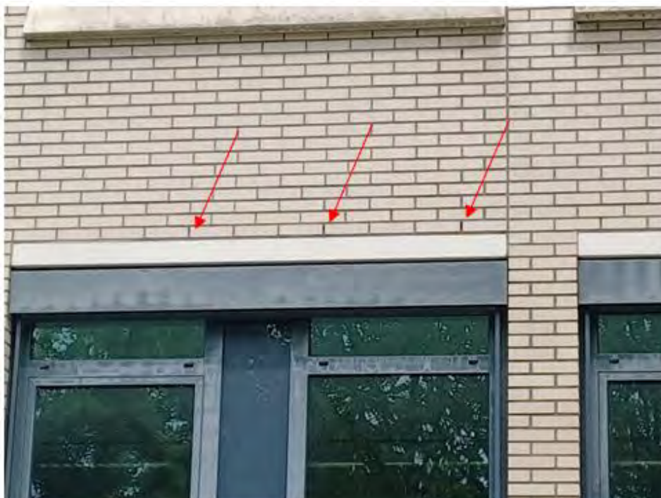
Figuur 3.2 Open stootvoegen zijn verspreid over de diverse gevels van de panden aanwezig. Locaties aangegeven met rode pijlen
