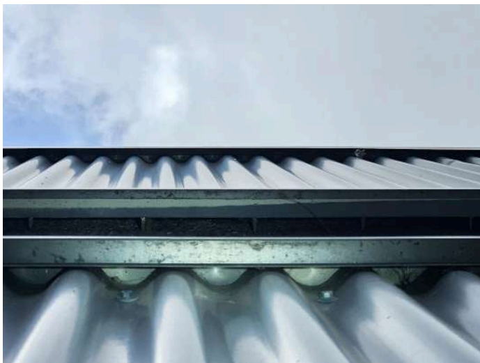
Afbeelding 12. Opening tussen beplating en achterliggende muur.
