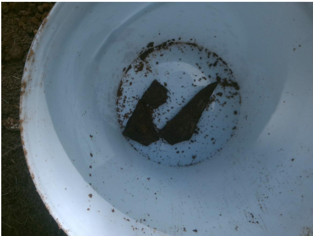
Foto 75. Asbestverdacht (plaat)-materiaal sleuf S4-22
