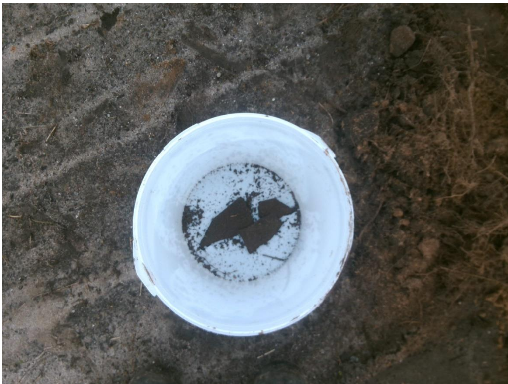
Foto 91. Asbestverdacht (plaat)-materiaal sleuf S4-31
