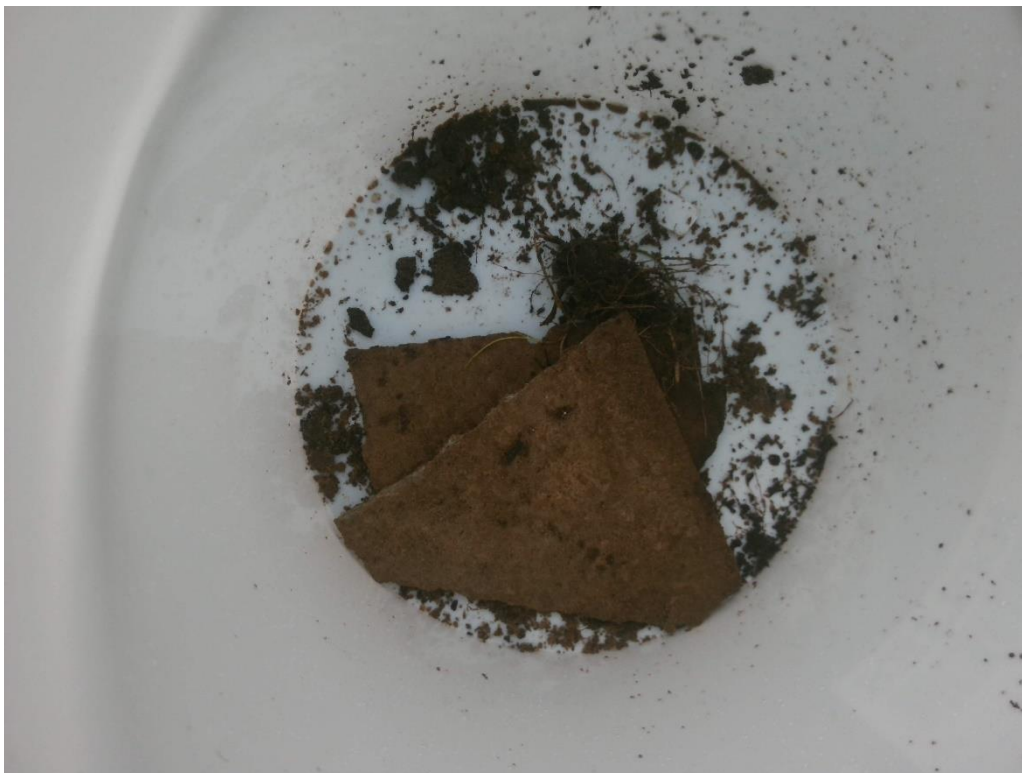
Foto 69. Asbestverdacht (plaat)-materiaal sleuf S4-19
