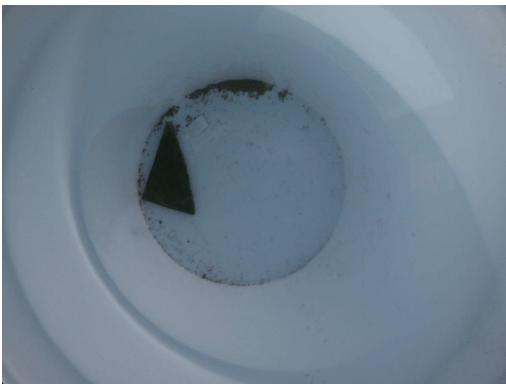
Foto 24. Asbestverdacht (plaat)-materiaal sleuf S2-09
