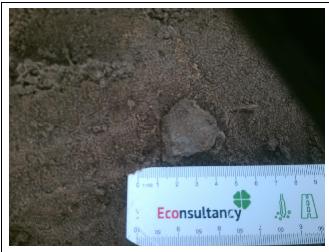
Foto 15. Asbestverdacht (plaat)-materiaal C4
