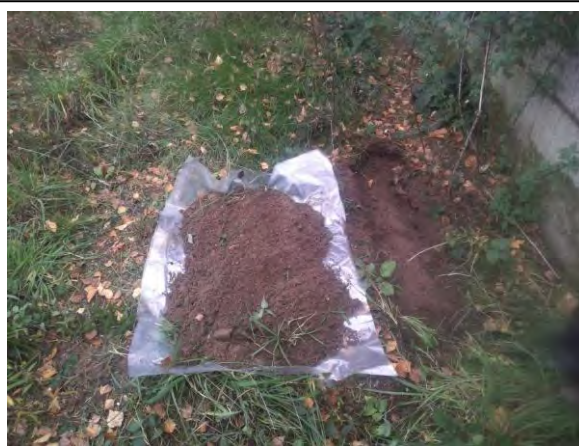
Foto: Inspectiegat E02
