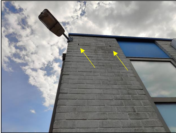
Open stootvoegen in metselwerk, potentiële invliegopening.
