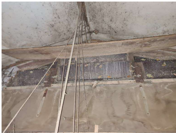
Figuur 5.6: gaasnet in luchtinlaat - binnenzijde
