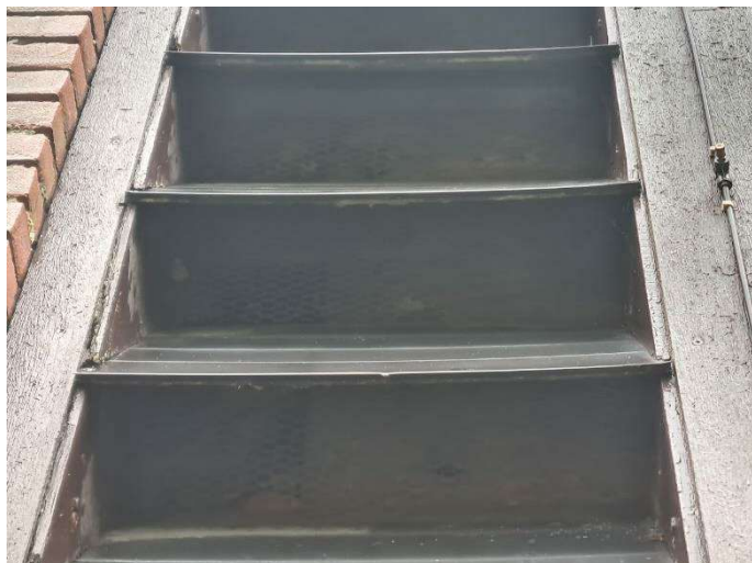
Figuur 3.5: gaasnet in luchtinlaat - buitenzijde
