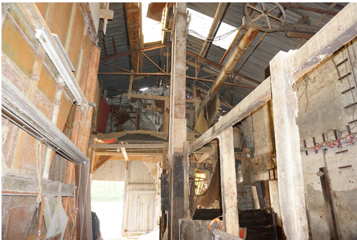
Figuur 1.6 Onder het golfplaten dak is geen plafond aanwezig.
