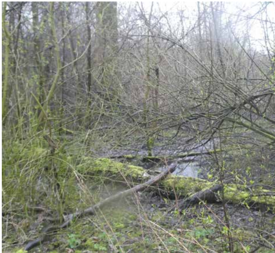
Niet onderhouden greppel door bos
